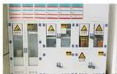
一体化试剂储存设施
